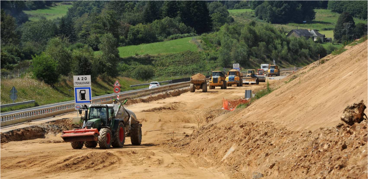
Chantier d'aménagement en section autoroutière de l'ancienne route départementale RD9, entre l'échangeur de Saint-Germain-les-Vergnes et Saint-Pardoux-l'Ortigier, en Corrèze.
