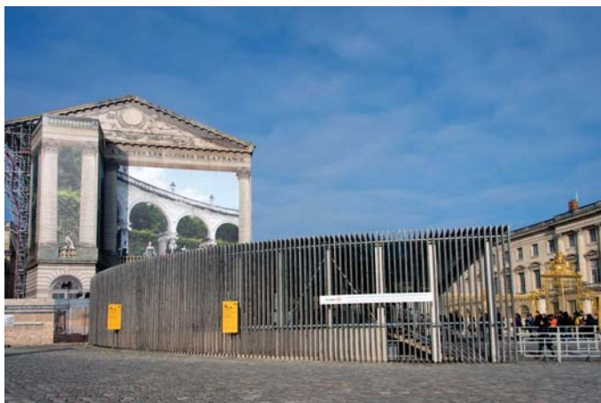
Le pavillon d'accueil temporaire, en arrière-plan le pavillon Dufour en travaux, février 2015 © château de Versailles, D. Saulnier
