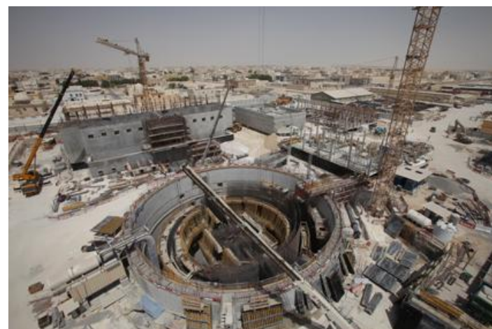
Station de pompage au Qatar
