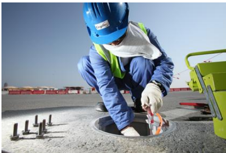
Cegelec au Qatar
