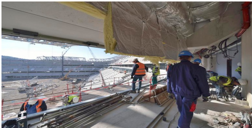
Protection incendie du Stade de Nice
