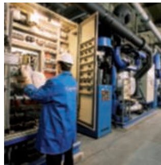
STATION DE POMPAGE DE CHOISY-LE-ROI, PRÈS DE PARIS
