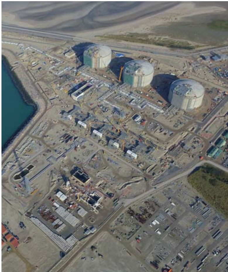
Vue aérienne des trois réservoirs du projet Dunkerque LNG, France.
