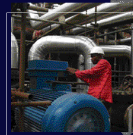
Équipement Kaduna-NIGERIA / Equipment Kaduna-NIGERIA
