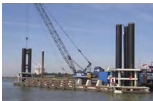
Point d'amarrage flottant pour les bateaux fluviaux au milieu de l'Escaut à hauteur de Lillo. Design and Construct: Geka.
