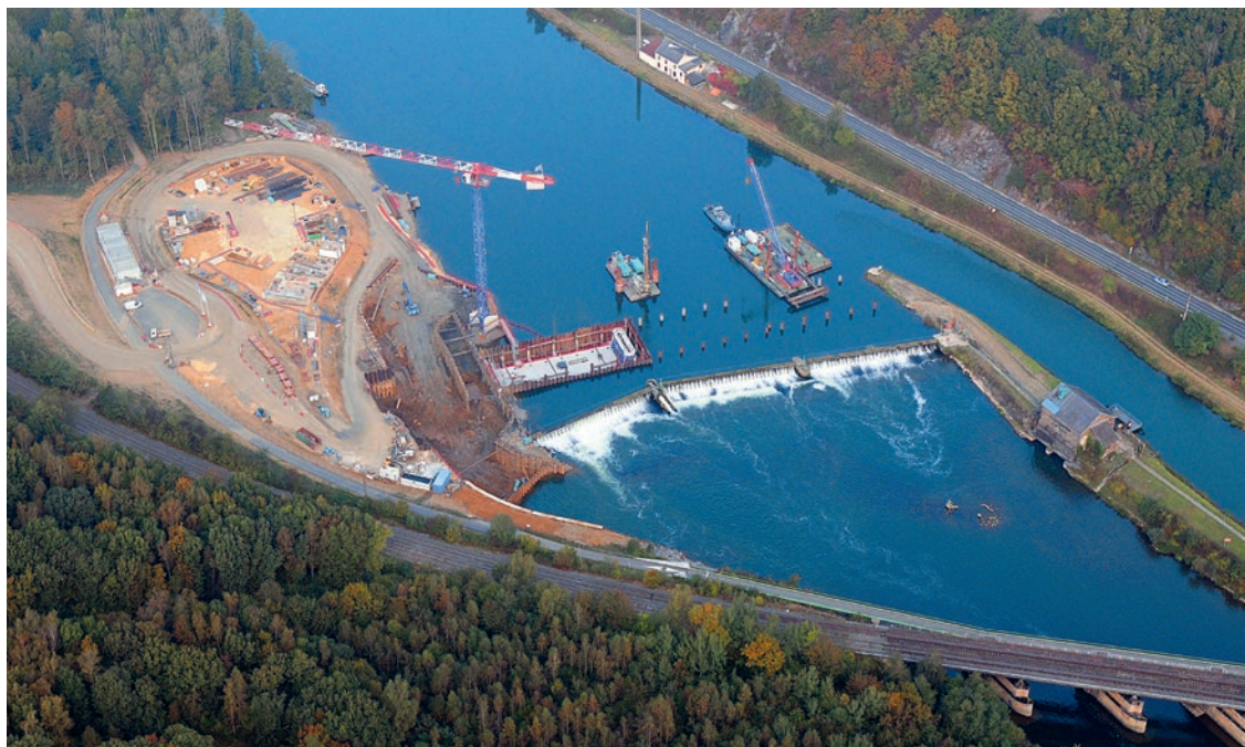
L'automatisation des barrages, un élément clé de la modernisation du réseau fluvial français.
