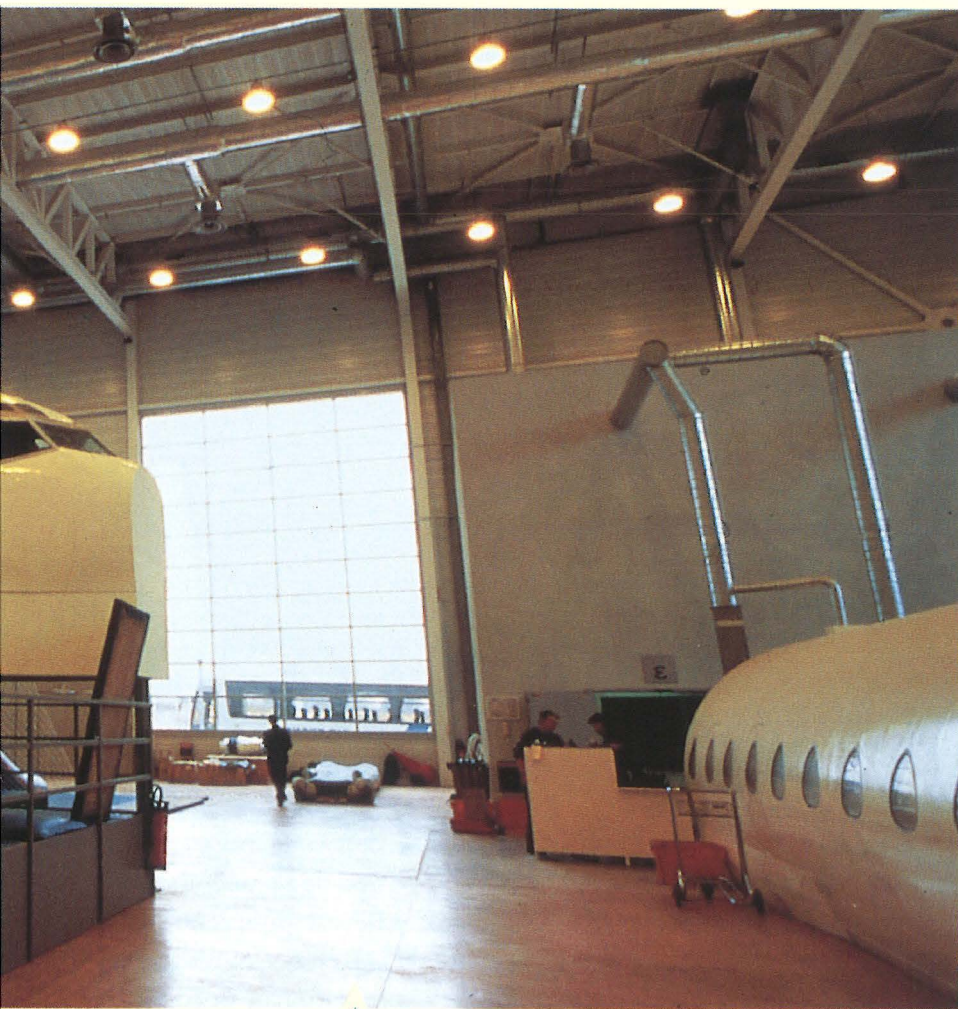
Tunzini a réalisé la climatisation du nouveau siège d'Air France à Roissy.
