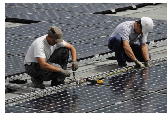
Conception et réalisation d'une centrale photovoltaïque sur le Géant Casino de Pessac (France)
